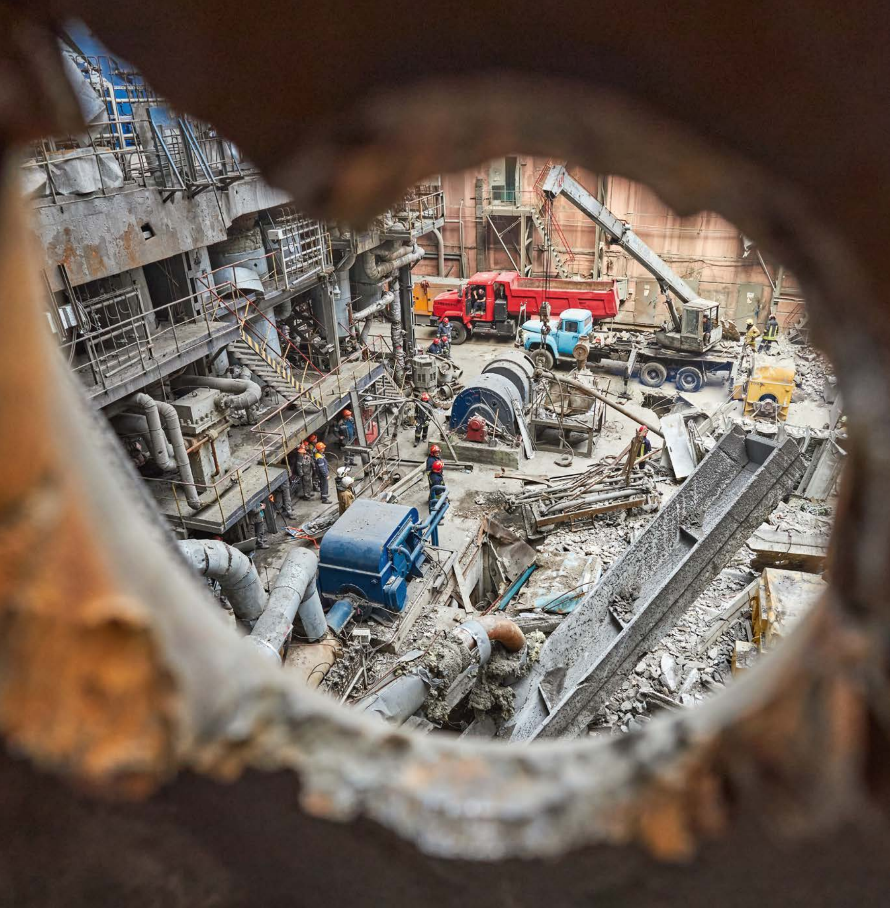
Крізь осколкову пробоїну проглядається, як інженери відновлюють пошкоджену теплоелектростанцію. Серж Сердюков, 2024 р.
